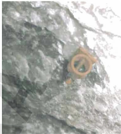
Abbildung 3-5: Quetschkörper an der Firste des Abbaus 8s
